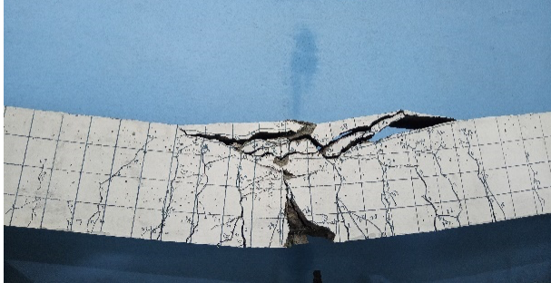
Gambar 14. Keruntuhan Balok BL 21 Sumber: Dokumentasi Pribadi
